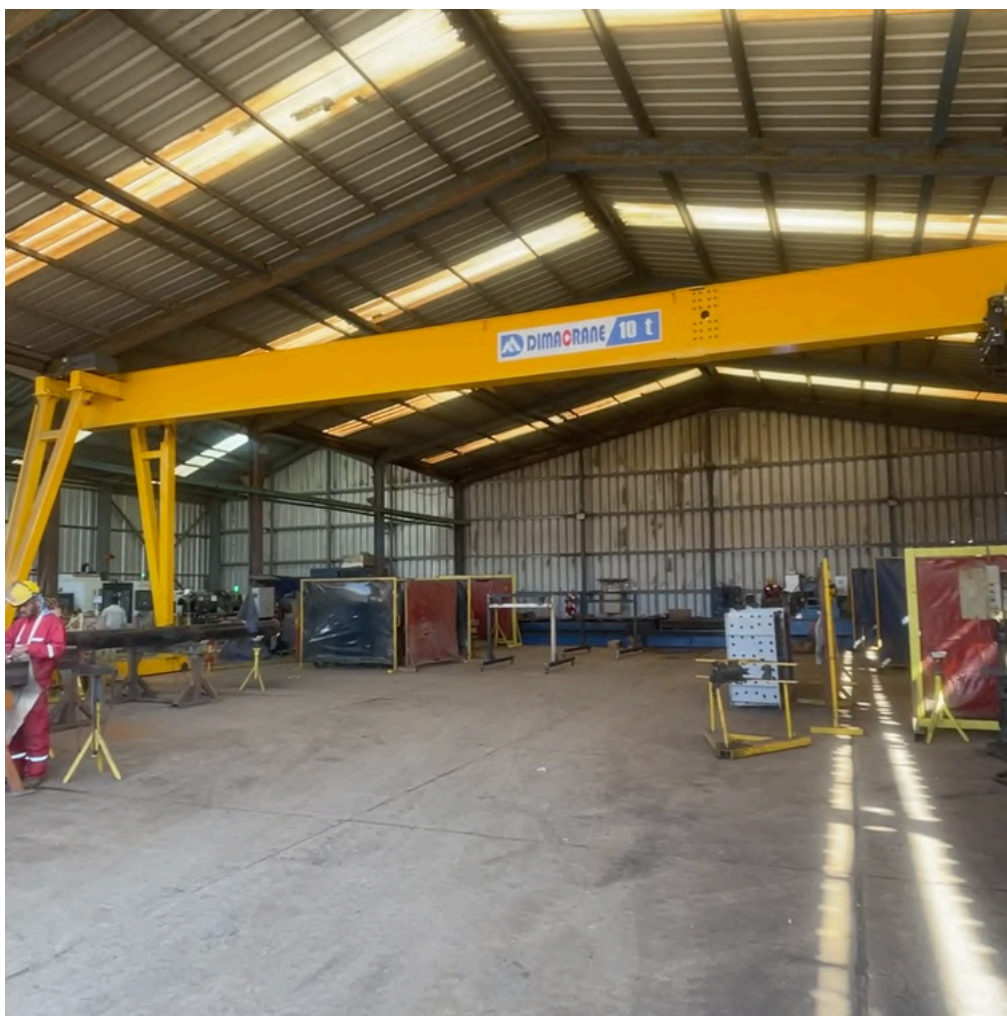
PUENTE GRÚA DE 10 TONELADAS
